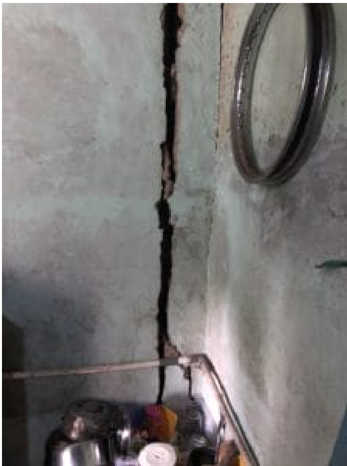
Risse verursacht durch die Sprengungen. © Joanna Klabisch
