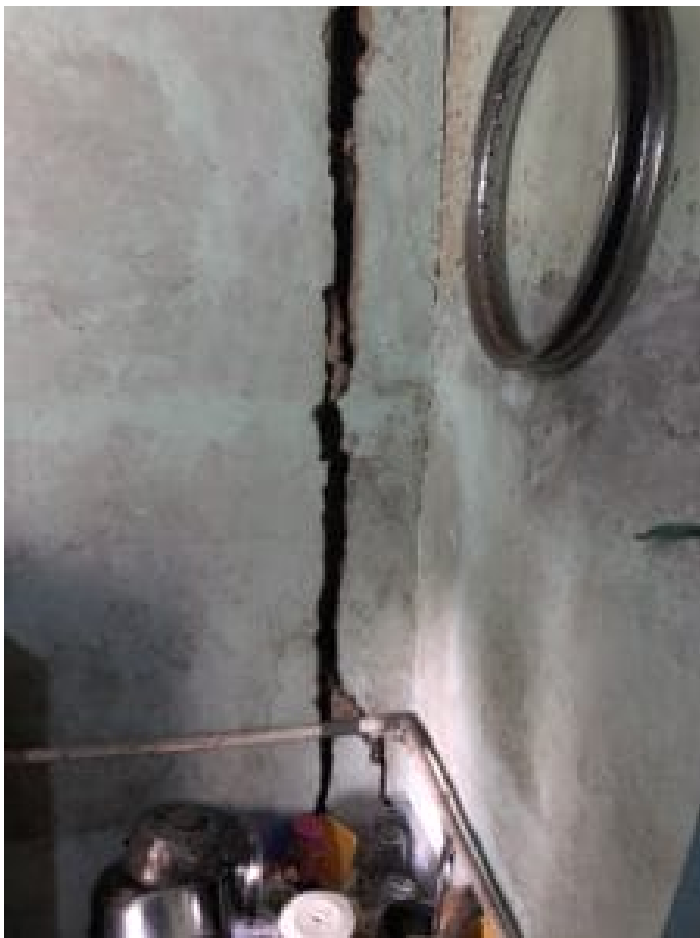
Risse verursacht durch die Sprengungen. © Joanna Klabisch
